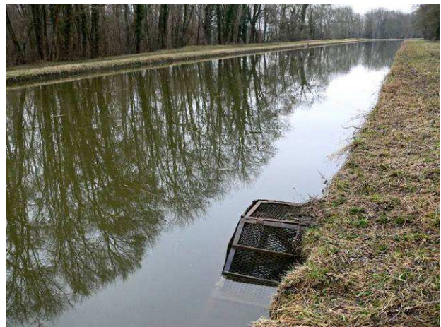
A proximité du dispositif précédent de l'autre côté du canal ce dispositif en grillage dimensionné pour le chevreuil. La structure est dégradée et devrait être remplacée. ©V. Vignon
