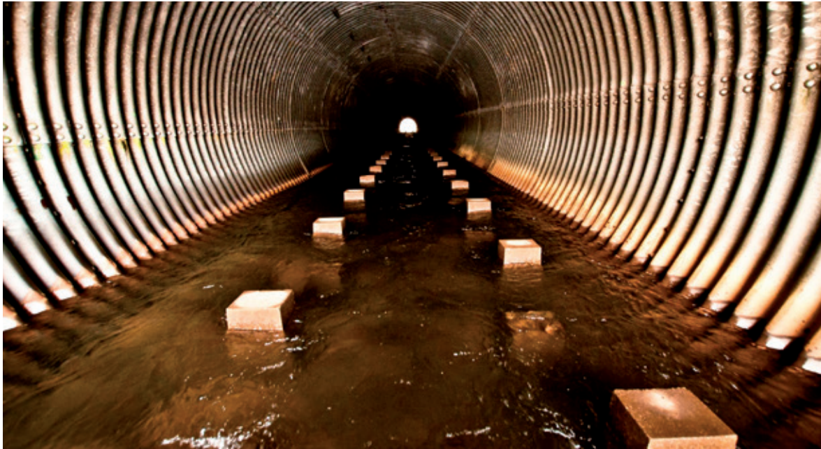
Figure 2: Buse OH 448, de type ARMCO en tôle ondulée, longue de 104 mètres et présentant une pente de 1%.
