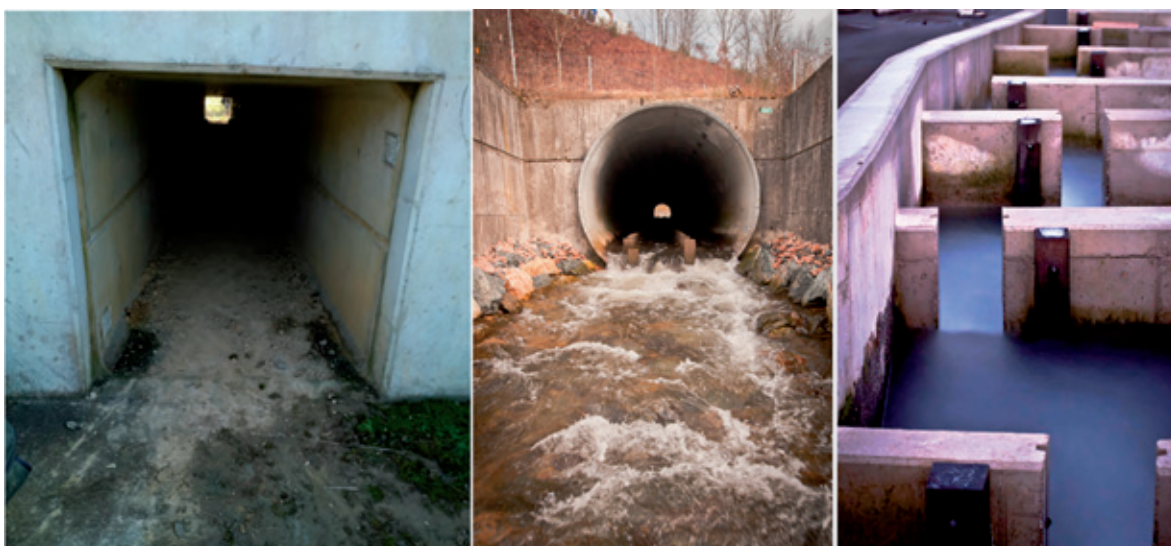
Figure 30 : Exemples d'ouvrages dont la fonctionnalité peut être évaluée par RFID : batrachoduc (Testud et al. 2019), buse d'écoulement (étude SCIMABIO Interface pour ASF), passe à poissons (étude SCIMABIO Interface)
