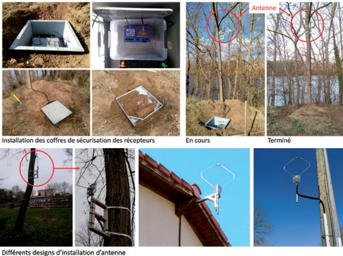
Figure 24 : Photos d'exemples d'installation de stations fixes et d'antennes.
