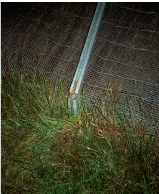
Figure 15 : Rupture des poteaux de la clôture équipée de panneaux de bande à la suite de la tempête ANA en 2017. ©VINCI Autoroutes.
