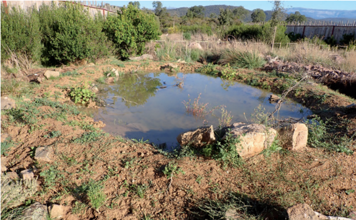
Figure 25 : Un essai de protection avec une nappe de grillage enterrée est en cours d'expérimentation (écopont des Adrets-de-l'Estère). L'alternance de sable, de géotextiles, de membranes (Bidim/EPDM) associée à un grillage avec fers de placages ancrés donne de bons résultats après une année. ©Cabinet X-AEQUO.
