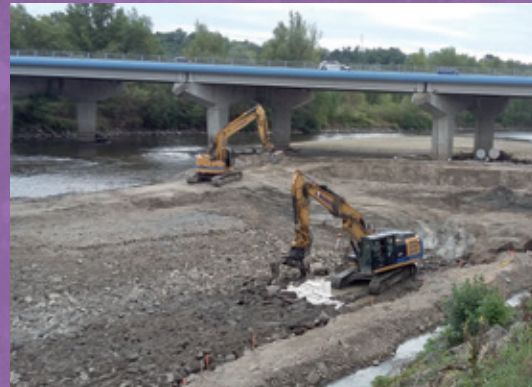
Figure 41 : Les travaux sont réalisés de manière progressive depuis une berge vers l'autre, dans le lit en amont du seuil et nécessitent le déplacement de blocs volumineux pour la formation de la rampe. ©Photothèque VINCI Autoroutes
