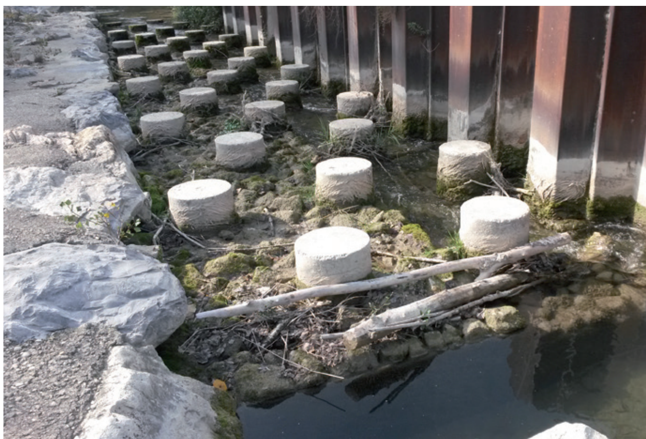
Figure 50 : Embâcle en entrée de rampe piscicole, rendant l'aménagement inutilisable par les poissons ©Photothèque VINCI Autoroutes
