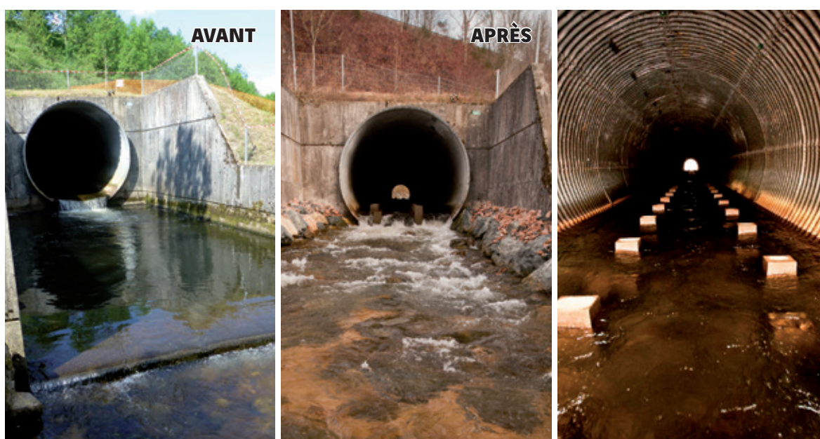
Figure 83 : Présentation de la buse avant travaux (à gauche) et après travaux (au centre et à droite). Source ASF.
