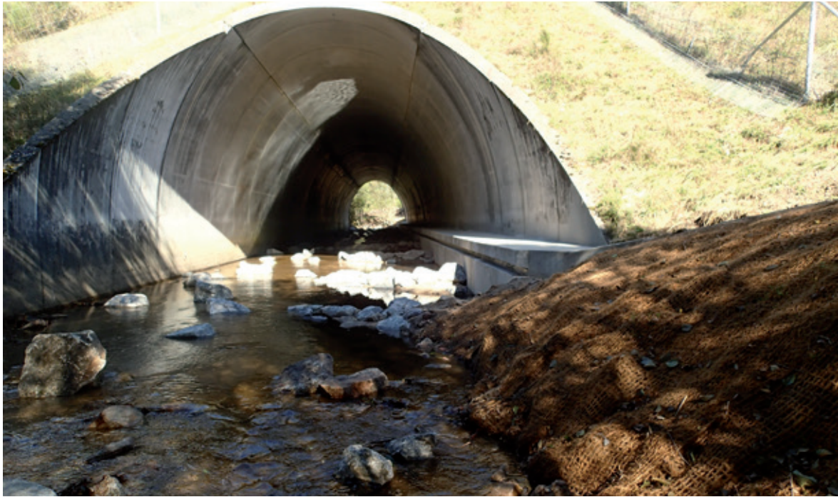
Figure 86 : Vue générale de l'ouvrage du Deiro et son réaménagement pour la petite faune (photos prises en phase de chantier). ©GREGE.
