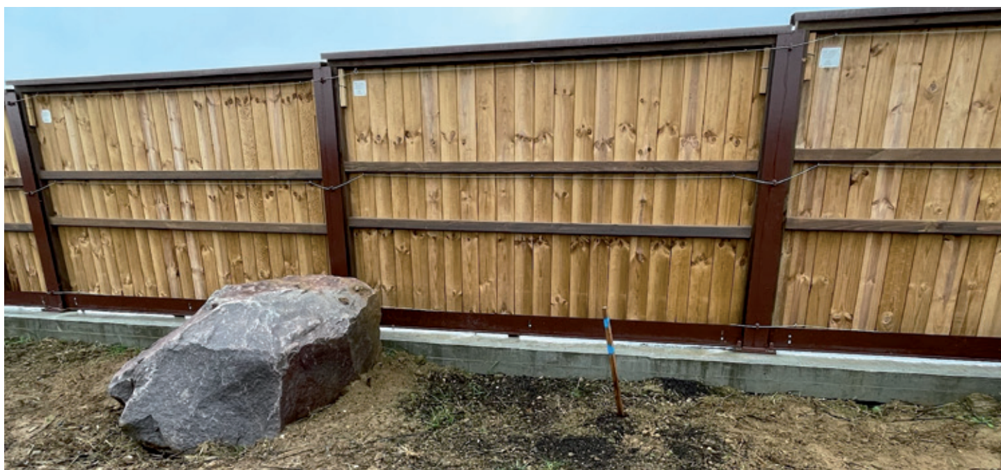
Figure 13 : Sur le contournement ouest de Strasbourg, les panneaux sont liés entre eux par un câble métallique et reliés au sommet des montants métalliques. Dans le cas d'une éventuelle rupture d'un des éléments, cela permet d'éviter une chute sur les voies (câble de 4 mm de diamètre en inox). ©VINCI Autoroutes.
