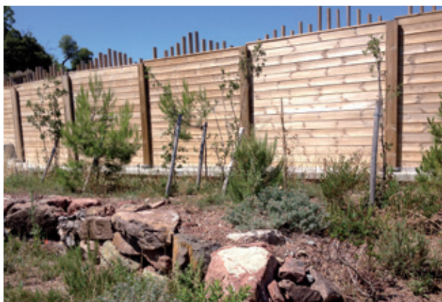
Figure 27 : Éco-restanque volontairement effondrée pour atteindre le niveau du sol. ©Photothèque VINCI Autoroutes
