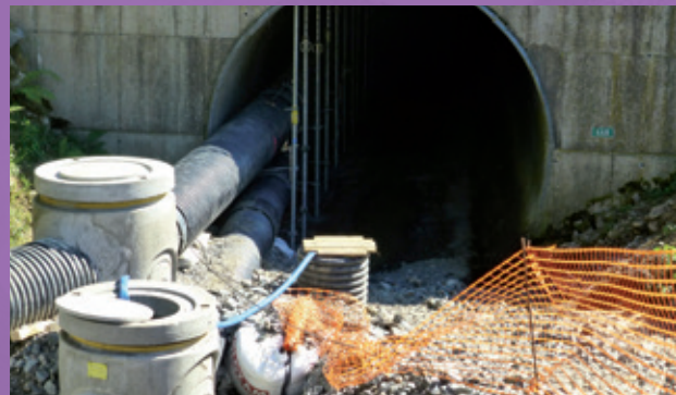
Figure 38 : Mise en place de batardeaux et dérivation du cours d'eau pour permettre un travail en assec. ©Photothèque VINCI Autoroutes
