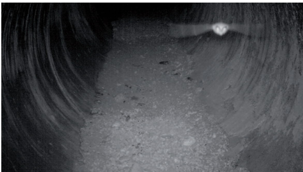
Figure 64 : Donnée ponctuelle d'un Chiroptère indéterminé photographié en transit dans une buse de 120 centimètres de diamètre. ©ASF/LPO France.
