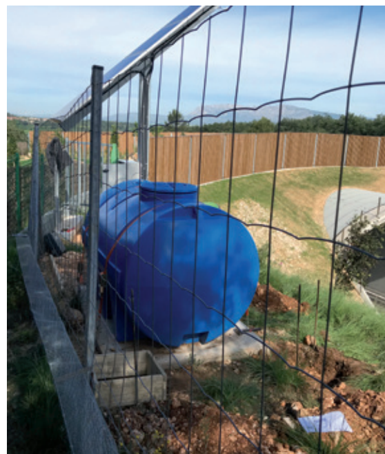
Figure 20 : Installation d'une cuve de stockage équipée d'un panneau solaire et alimentée par un forage. ©Cabinet X-AEQUO.
