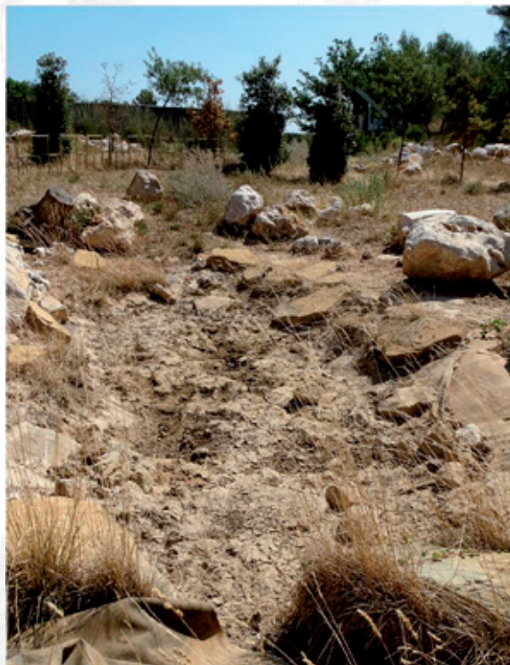
Figure 26 : Affoulement d'une mare par des Sangliers. Une réflexion doit être envisagée à la création pour garantir la pérennité de l'aménagement et du dispositif d'étanchéité installé. ©VINCI Autoroutes.
