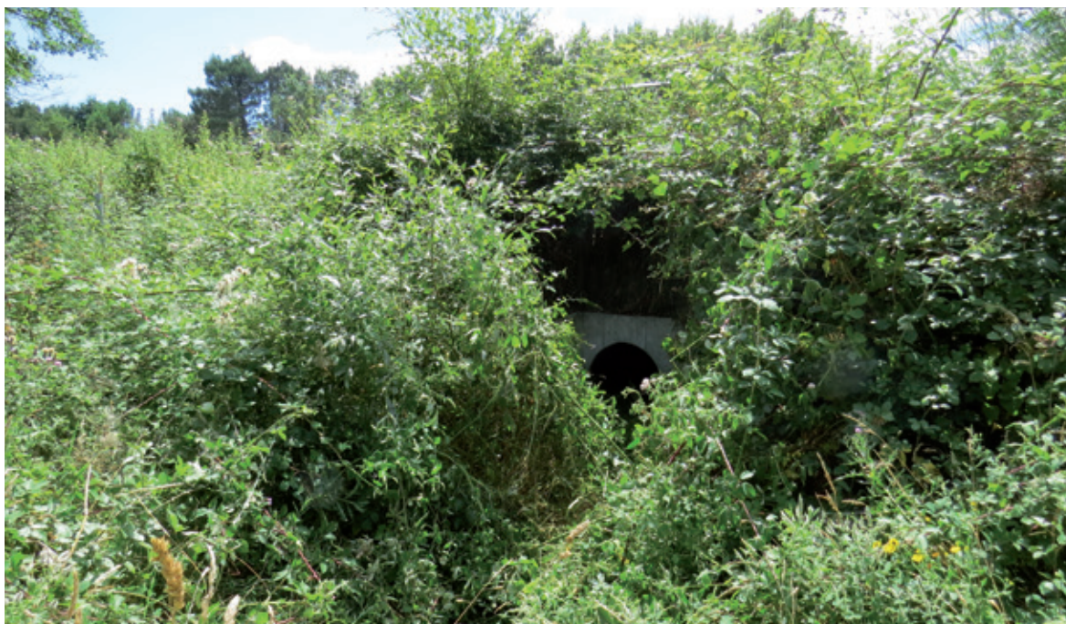
Figure 58 : entrée d'un écoduc de 80 centimètres de diamètre envahi par la végétation et rendant le suivi du piège photo de l'entrée impossible. ©ASF/LPO France.
