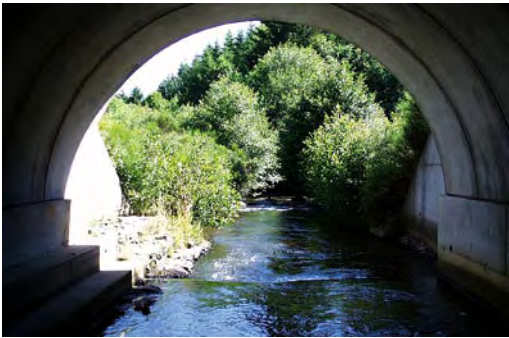
Photo 5 : passage à loutre de la RN 89 sur la Clidane (V. Billon, CETE de Lyon)
