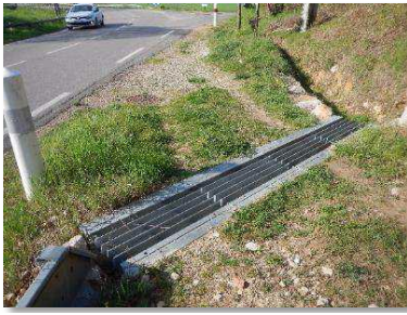
Exemple de caniveau – grille © Conseil départemental de la Savoie
